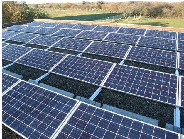
Statkrafts første solpark i Tyskland ble bygget i 2018 ved siden av selskapets vannkraftverk i Dörverden. Parken på 750 kW er et testanlegg for solkraft i kombinasjon med batterier.
