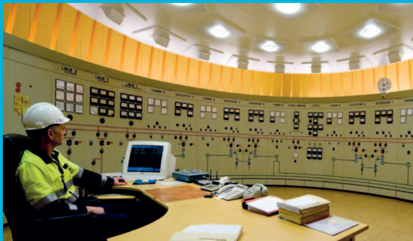
Kontrollrommet på Mår kraftverk
