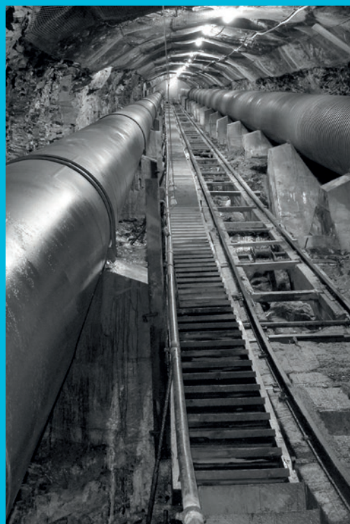
Rørgate i Aura kraftverk
